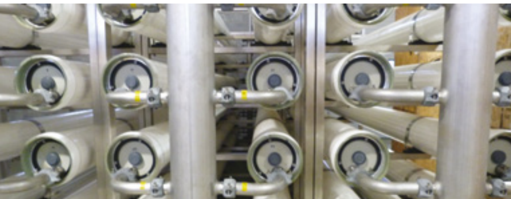
De installatie voor omgekeerde osmose.
